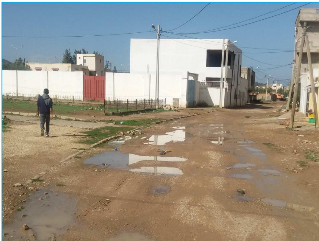
Voie revêtu en bicouche en état dégradé
